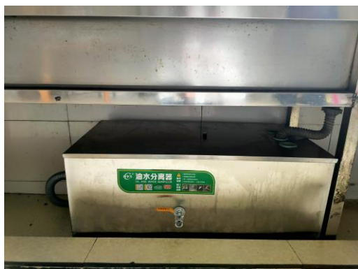
图 3-1 废水处理设施
