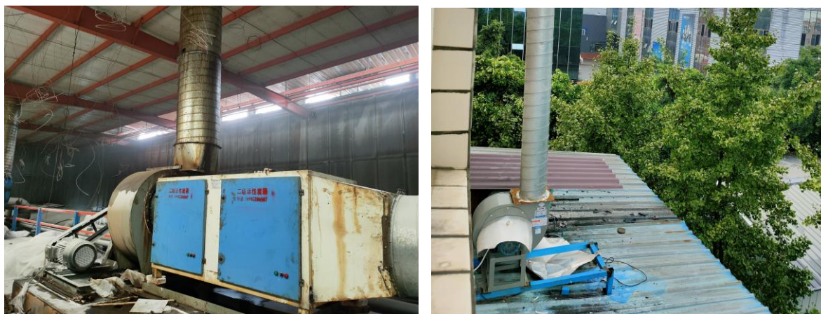
图 3-2 废气处理设施
