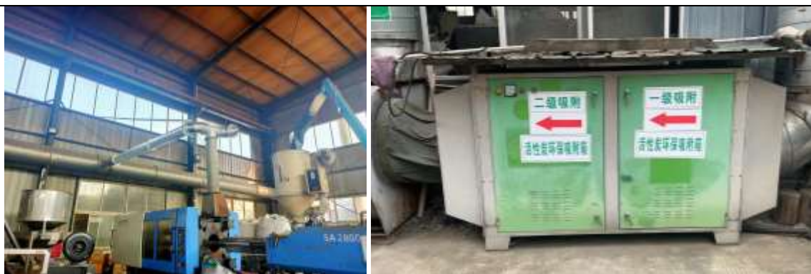
图 3-1 废气处理设施
